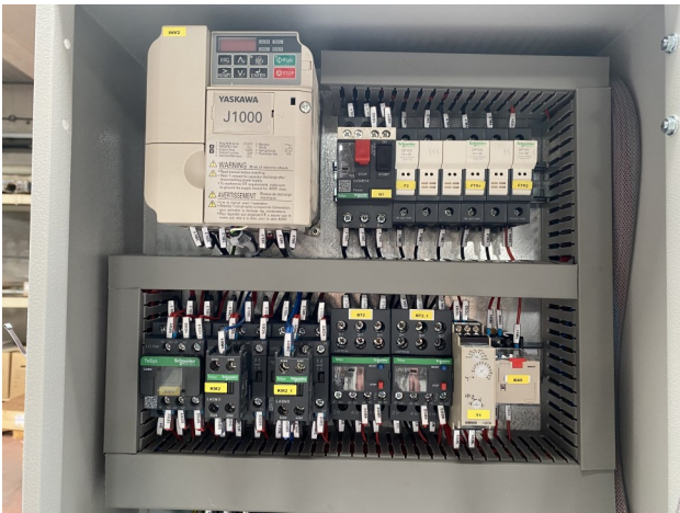
Interno del pannello: inverter per la regolazione velocità' avanzamento
