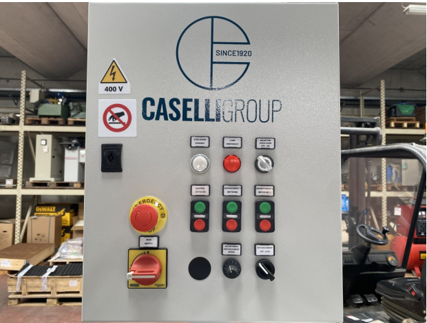
Quadro elettrico di comando
